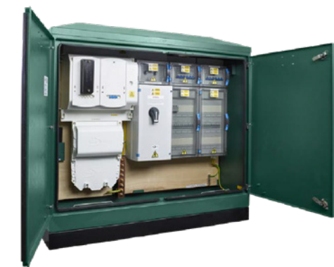
▲ EV feeder pillar.
